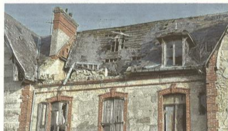
Toit effondré, huisseries défoncées, fientes de pigeons sur 50 cm d'épaisseur, nids de guêpes si énormes que les pompiers ont eu besoin de deux demi-journées pour en venir à bout. Le chantier a duré un an.
